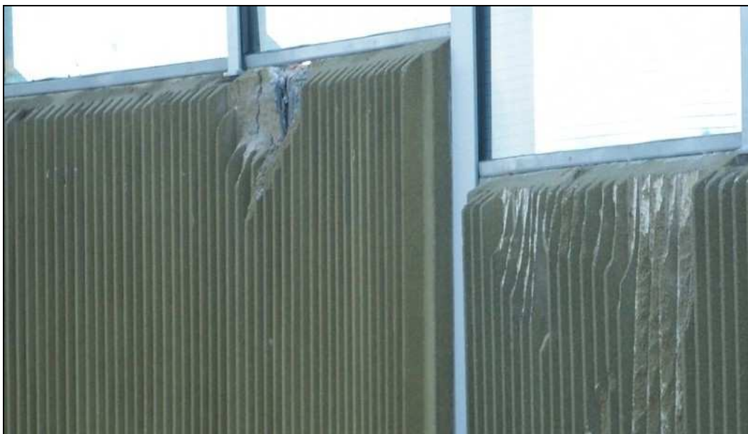
Zdj. Przykład uszkodzenia ekranu akustycznego wpływającego na pogorszenie jego skuteczności przeciwhałasowej przez niezachowanie szczelności (Źródło: www.trojmiasto.pl , fot. Maciej Naskręt)
