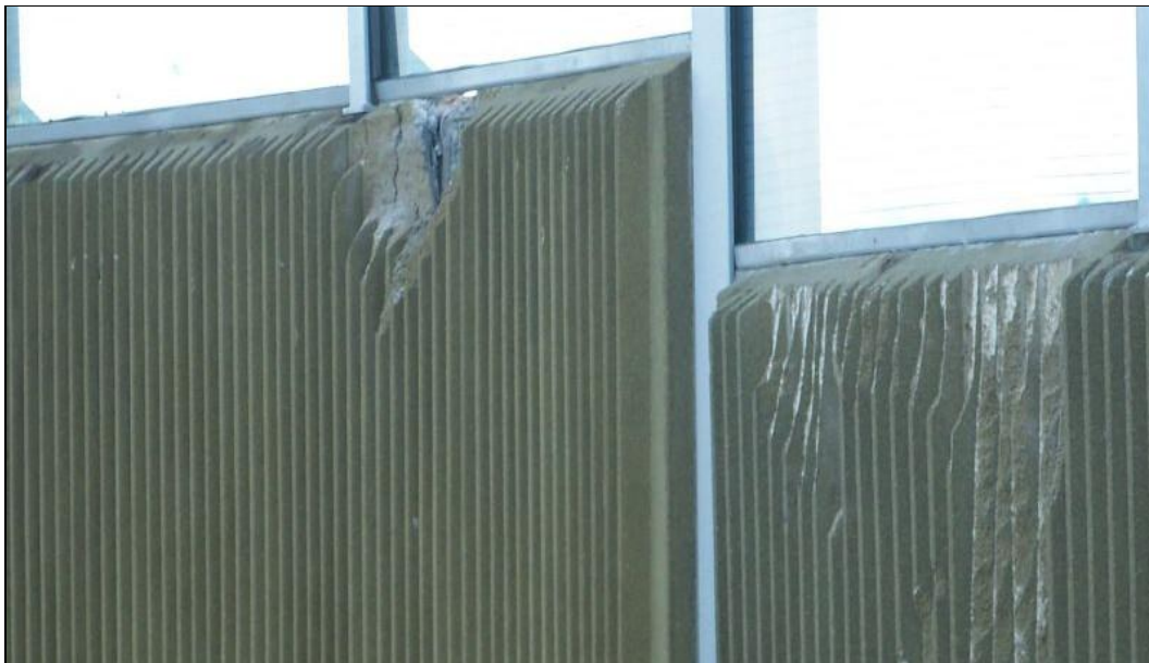
Zdj. Przykład uszkodzenia ekranu akustycznego wpływającego na pogorszenie jego skuteczności przeciwhałasowej przez niezachowanie szczelności (Źródło: www.trojmiasto.pl , fot. Maciej Naskręt)
