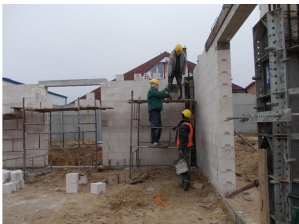
Brak barier chroniących przed upadkiem z wysokości, brak pionu komunikacyjnego, brak bezpiecznego posadawienia stojaków.
