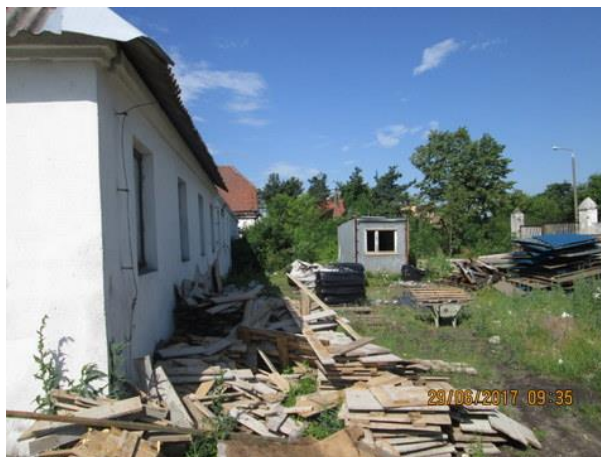
Brak zabezpieczenia terenu na zewnątrz budynku przed włóknami azbestu.
