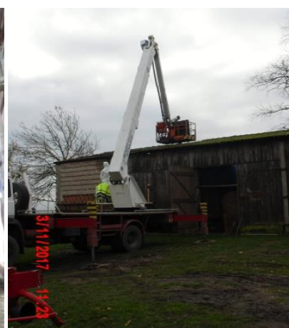
W innym terminie przeprowadzono demontaż płyt falistych przy użyciu podnośnika samochodowego – pracownik demontował płyty z kosza podnośnika.
