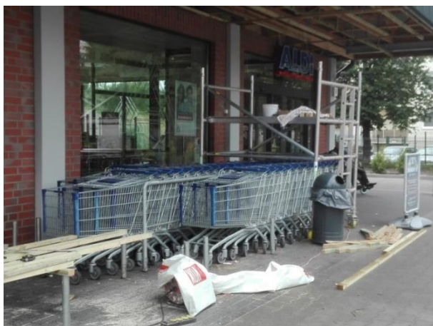
Wózki na zakupy dla klientów ustawiane pod podestem rusztowania, stanowiska pracy robotników budowlanych bez wyznaczonej strefy niebezpiecznej w czynnym sklepie..
