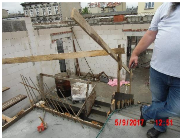
Nieprawidłowo zamontowane w klatce schodowej i otworach okiennych balustrady, bez poręczy pośrednich i bez zapewnionej ich sztywności.
