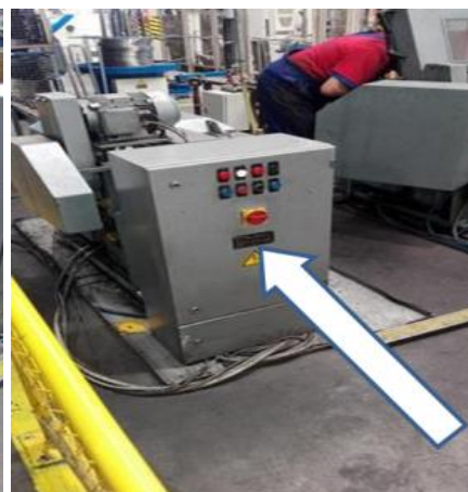
Zamontowany w wyniku realizacji decyzji ustnej łącznik energii elektrycznej
