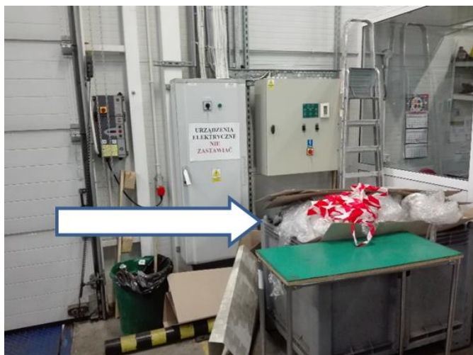
Zastawiony składowanym towarem, dostęp do rozdzielnicy elektrycznej
