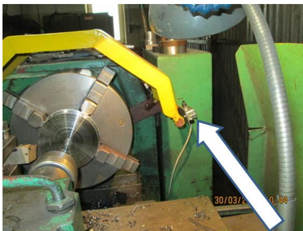
Zainstalowany wyłącznik krańcowy, rozłączający po podniesieniu osłony ruch obrotowy uchwytu tokarskiego
