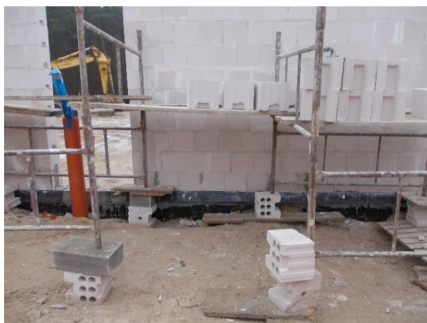
Brak bezpiecznego posadawienia stojaków, pomosty robocze położone niezgodnie z instrukcją producenta.
