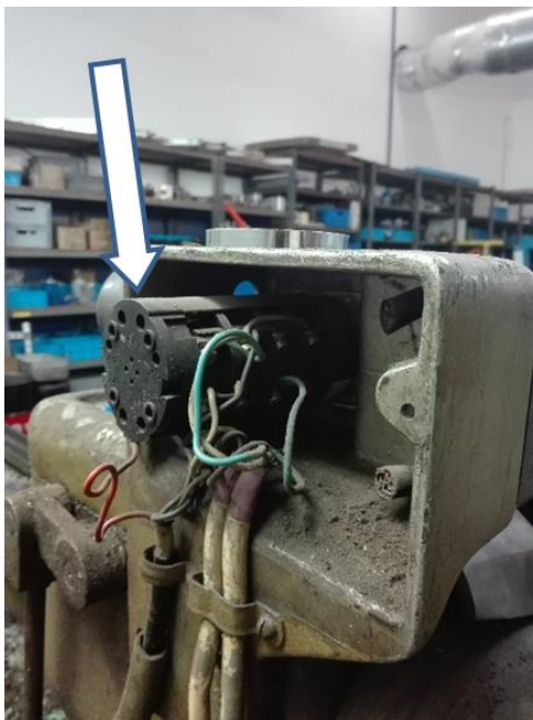
Puszka rozdzielcza instalacji elektrycznej znajdująca się na tokarce do metalu nie posiadająca tylnej osłony przewodów roboczych instalacji elektrycznej będącej pod napięciem
