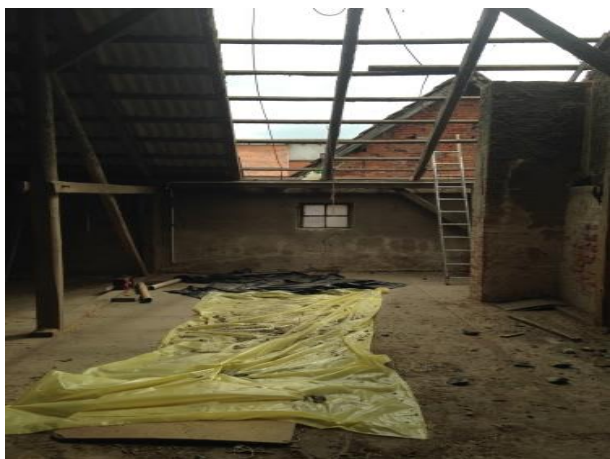
Niewłaściwe zabezpieczenie wnętrza budynku podczas demontażu płyt eternitowych z dachu obiektu. Wykonawca demontażu nie posiadał odkurzacza z filtrem HEPA.
