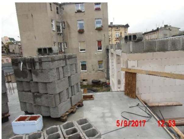
Brak zabezpieczenia zbiorowego, w tym brak poręczy pośredniej i bortnicy przy istniejącej balustradzie.
