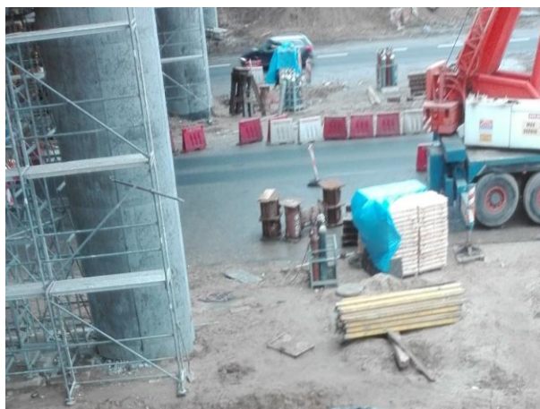
Brak pełnego oznakowania stref niebezpiecznych przy rusztowaniu, przy żurawiu oraz przejść pomiędzy stanowiskami pracy przy czynnych dla ruchu drogach.
