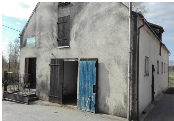
Prawidłowe zabezpieczenie drzwi przed samoczynnym zamknięciem
