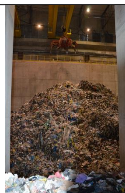
Tak jest. Spalarnia odpadów komunalnych, bunkier zasypowy odpadów, Bydgoszcz ProNatura ZTPOK (foto: Bydgoszcz, październik 2015r)
