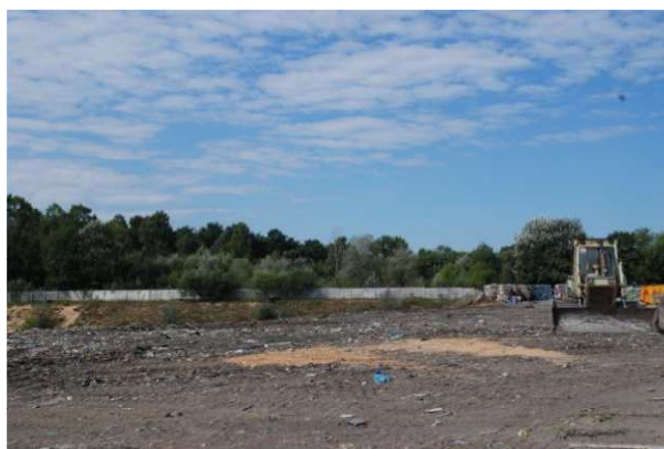
Rysunek 38 Tak było. Składowisko odpadów, Lipno (sierpień 2013r)
