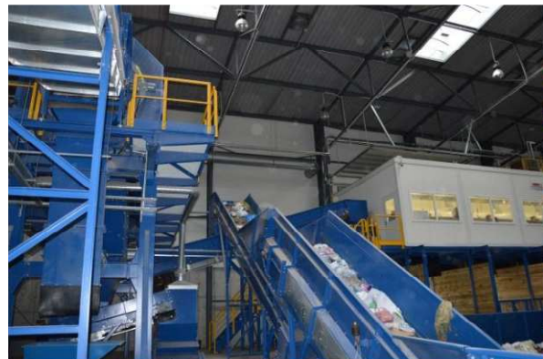
Rysunek 10 Tak jest. Nowa sortownia odpadów (komunalnych zmieszanych i surowcowych), Sulnówko (foto: Sulnówko, wrzesień 2015r).
