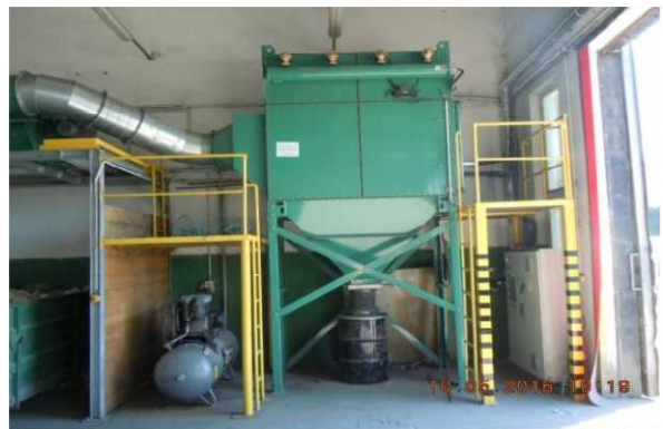
Rysunek 30 Tak jest. Sortownia odpadów komunalnych zmieszanych i selektywnie zebranych – separator powietrzny, Puszcza Miejska (foto. Puszcza Miejska, październik 2015r.)
