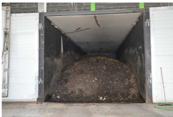
Rysunek 16 Tak jest. Instalacja do stabilizacji i kompostowania - w eksploatacji, Zakurzewo (foto: Zakurzewo, wrzesień 2015r).
