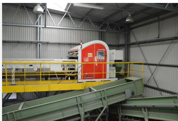
Rysunek 24 Tak było i jest. Separator optoelektroniczny w sortowni odpadów komunalnych, Niedźwiedź (foto: Niedźwiedź, wrzesień 2015r.)
