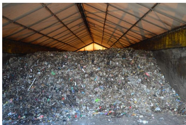
Rysunek 73 Tak jest. Instalacja stabilizacji frakcji biodegradowalnej wydzielonej ze zmieszanych odpadów komunalnych, Toruń MPO (Toruń, MPO, wrzesień 2015r)
