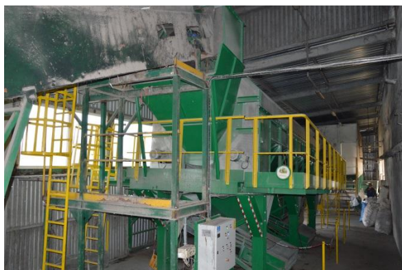
Rysunek 28 Tak jest. Sortownia odpadów komunalnych zmieszanych i selektywnie zebranych - sito bębnowe, Puszcza Miejska (foto. Puszcza Miejska, październik 2015r.)
