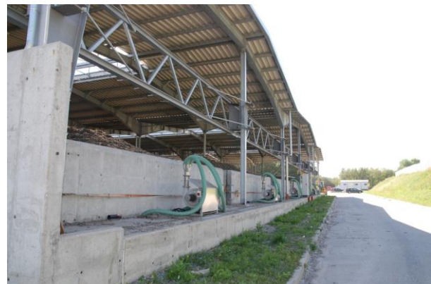
Rysunek 77 Tak było i jest. Instalacja do stabilizacji biologicznej odpadów – proces suszenia, Wawrzynki
