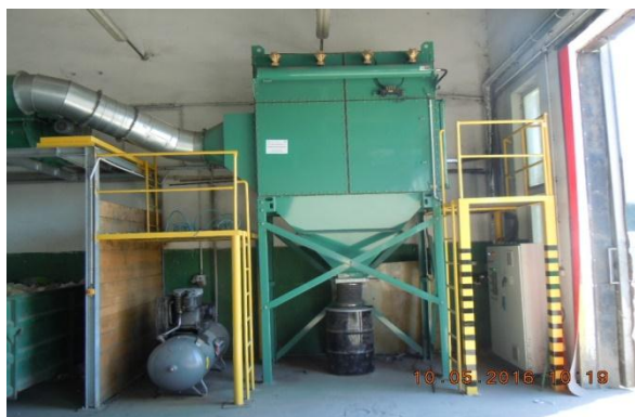
Rysunek 30 Tak jest. Sortownia odpadów komunalnych zmieszanych i selektywnie zebranych – separator powietrzny, Puszcza Miejska (foto. Puszcza Miejska, październik 2015r.)
