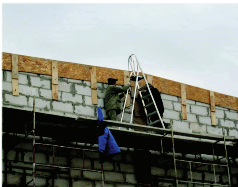
Pracownicy wykonujący montaż śrub skręcających szalunki wieńca z użyciem dodatkowej drabinki, brak balustrad ochronnych
