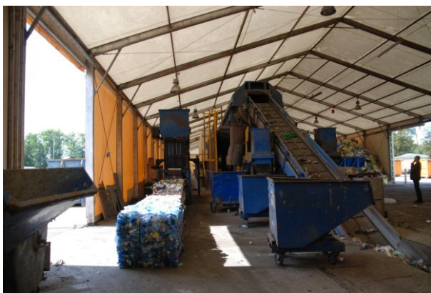
Rysunek 47 Tak było. Sortownia odpadów komunalnych, CORIMP Bydgoszcz (sierpień 2013r)
