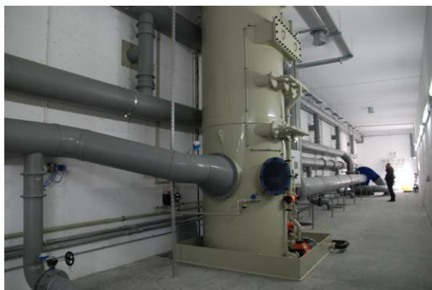
Rysunek 45 Tak było i jest. Instalacja stabilizacji frakcji biodegradowalnej wydzielonej ze zmieszanych odpadów komunalnych- system wentylacji, CORIMP Bydgoszcz (sierpień 2013r)
