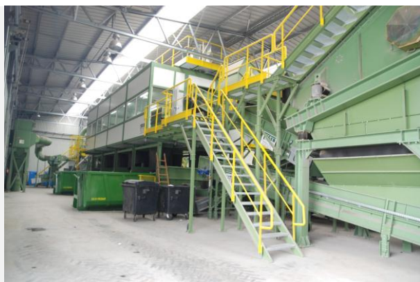
Rysunek 23 Tak było. Sortownia odpadów komunalnych, Niedźwiedź (sierpień 2013r)
