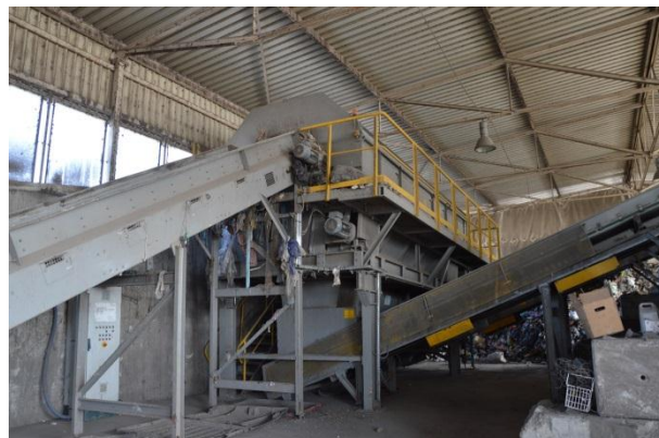
Rysunek 50 Tak jest. Nowa sortownia odpadów komunalnych zmieszanych (sortowanie wstępne), Remondis Bydgoszcz (foto: Remondis Bydgoszcz, październik 2015r)
