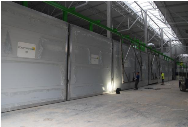
Rysunek 15 Tak było. Instalacja do stabilizacji i kompostowania -w budowie, Zakurzewo (sierpień 2013r)
