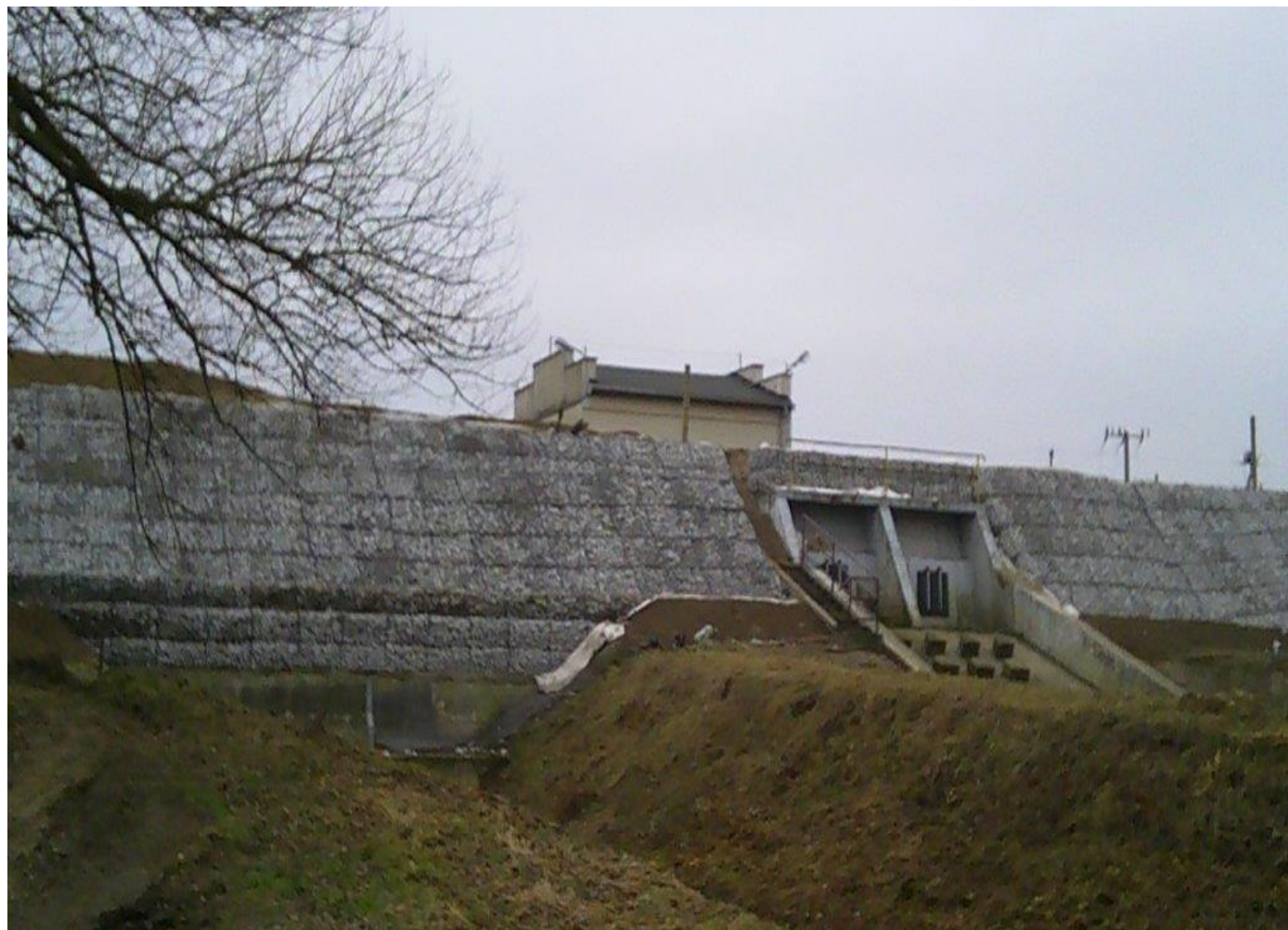
Fot. Wał Niziny Ciechocińskiej – inwestycja zrealizowana w 2014 r.
