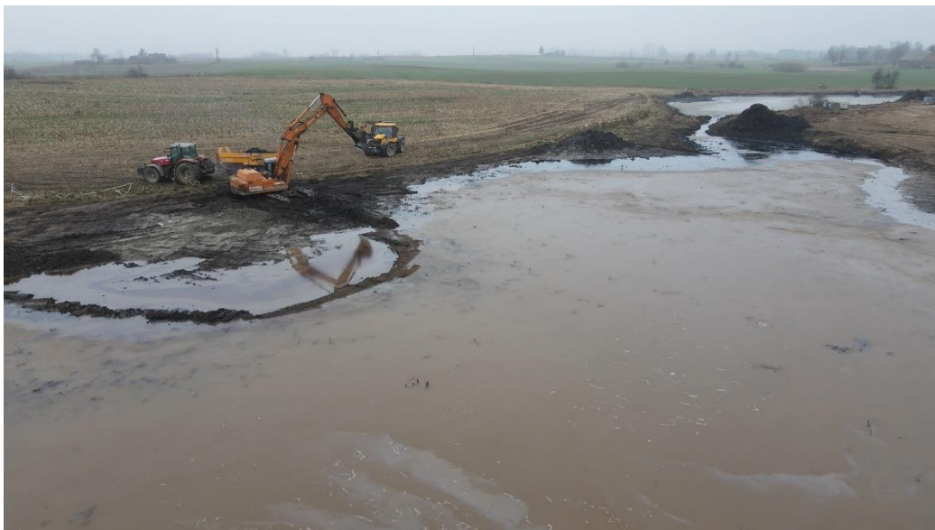
Zdjęcie nr 1. Dokumentacja fotograficzna wykonana podczas przelotu dronem nad miejscem rozszczelnienia rurociągu w m. Łania, gm. Chodecz.
