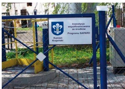
Fot. 26. Przepompownia ścieków w Kamieniu Krajeńskim
