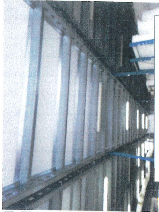
Zdjęcie nr 6 - strop w budy. produkcyjnym
