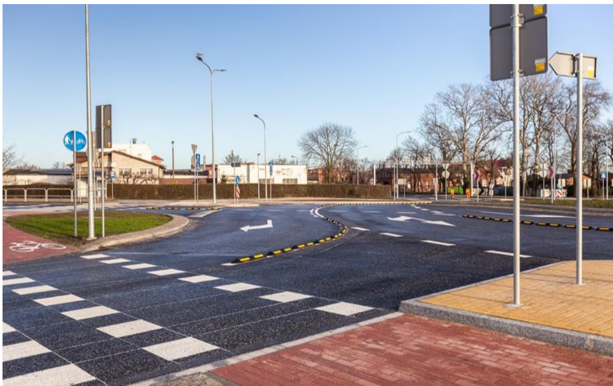
Nowe rondo turbinowe zrealizowane w ramach zadania pn.: „Rozbudowa skrzyżowania ulic: Stanisława Staszica, Górnicza, Poznańska, Prymasa Józefa Glempa w Inowrocławiu”, fot. Szymon Zdziebło
