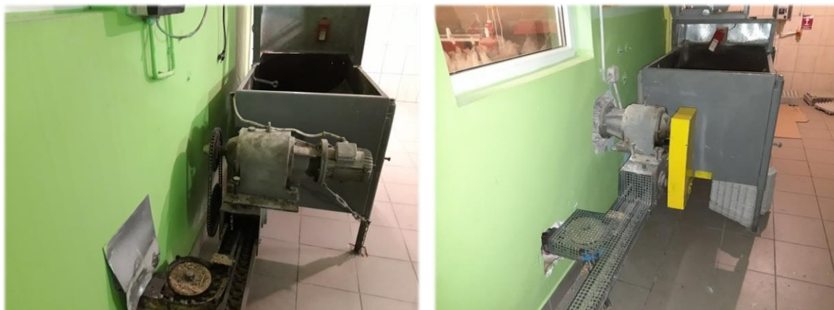
Fot. 1-2. Wagomąt paszowy z ciągiem transportującym pasze do kurników (brak zabezpieczenia dostępu do strefy niebezpiecznej przekładni łańcuchowych) - stan przed i po wykonaniu decyzji.
