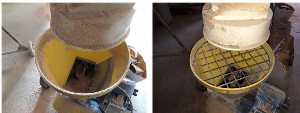
Fot. 5-6. Lej mieszalnika pasz z niezabezpieczonym dostępem do strefy niebezpiecznej - ślimaka transportującego pasze - stan stwierdzony w trakcie kontroli oraz stan po zrealizowaniu decyzji.
