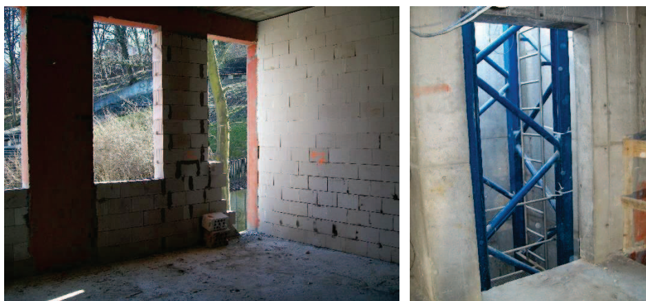
Brak balustrad ochronnych w otworach ściennych, w tym dla szybów dźwigowych
