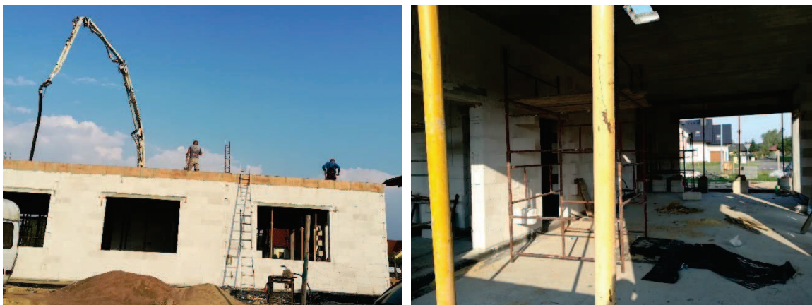
Brak zabezpieczenia przed upadkiem z wysokości podczas wykonywania prac betoniarskich, brak lub niewłaściwe urządzenia ochronne na rusztowaniach
