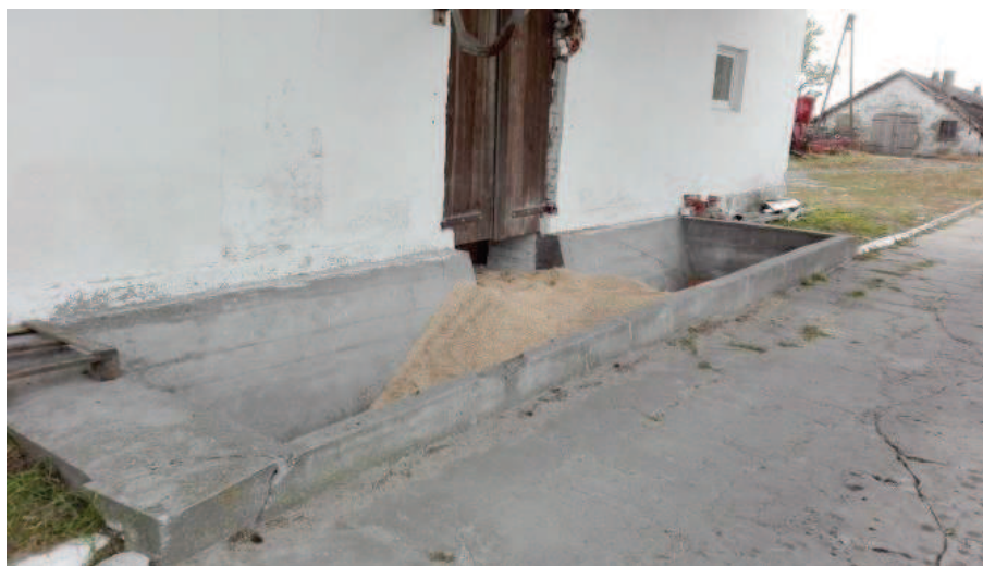
Lej zasypowy bez zabezpieczenia przed wpadnięciem.
