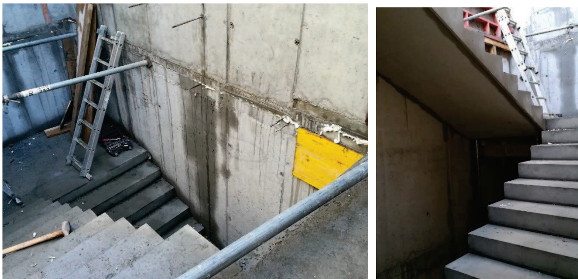
Brak zabezpieczenia przed upadkiem z wysokości przejść i dojść do stanowisk pracy na stropie oraz w całym biegu klatki schodowej
