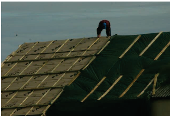
Fotografia wykonana podczas prac związanych ze zmianą pokrycia dachu budynku w miejscowości Bratwin. Pracownik nie został wyposażony w środki chroniące przed upadkiem z wysokości.
