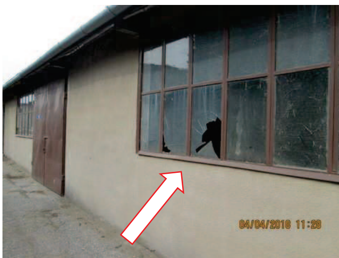
uszkodzone szyby w pomieszczeniu pracy,
