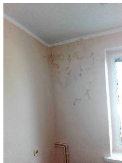
zacieki i odpadająca farba w pomieszczeniu pracy,
