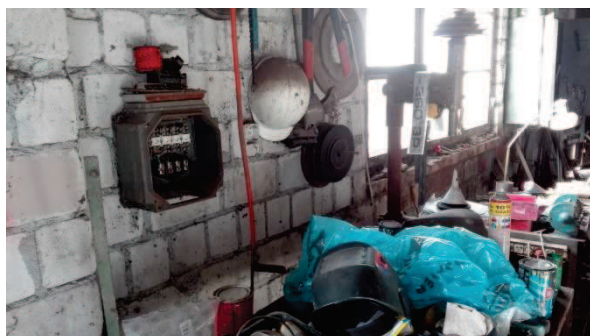
Fot. 16. Zły stan instalacji elektrycznej .
