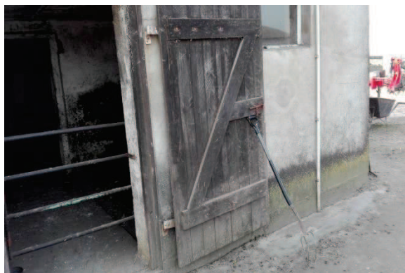
Fot. 11 Brak zabezpieczenia drzwi przed zamknięciem
